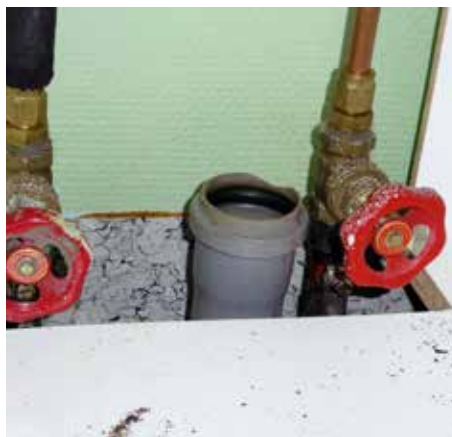
Ilustracja 3: Otwarty odpływ kanalizacyjny pozostawiony po demontażu.
