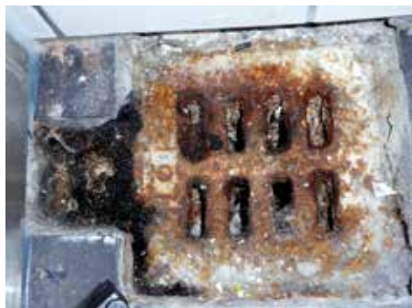
Ilustracja 4: Osuszony i zanieczyszczony odpływ podłogowy.
